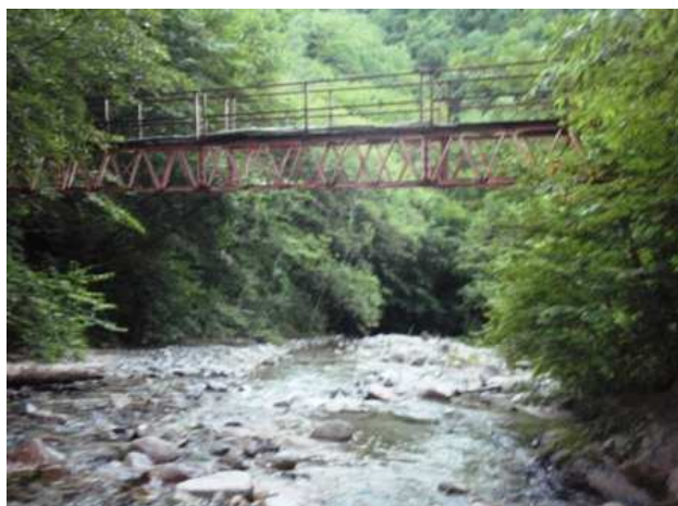
写真-4 崩壊寸前の鉄橋
