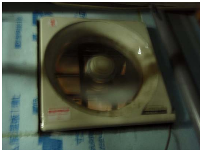
写真-6 地下室換気扇
